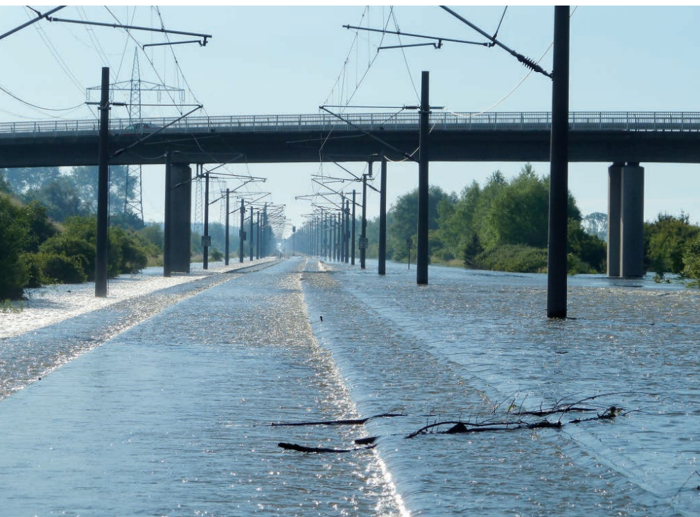
BILD 1: Fotoaufnahme vom 11.06.2013, überflutete Strecke 6185 ca. km 190,3, rechts im Bild Strecke 6107 ca. km 90,3
